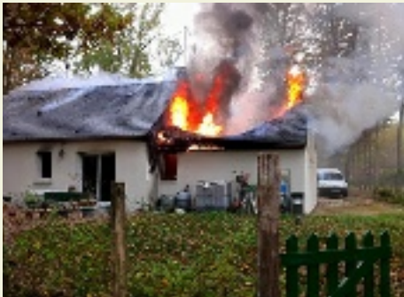
Le feu a occasionné de gros dégâts.
